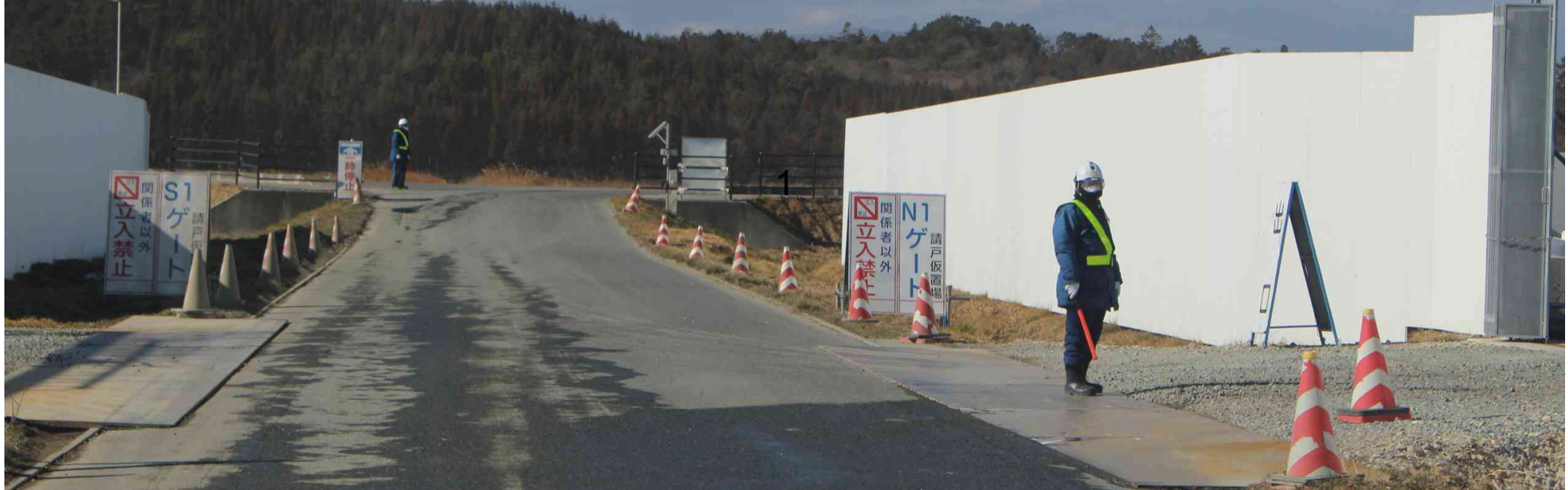
浪江町の請戸にある広大な仮置場。 除染土の山が点々と続き、物々しい雰囲気が漂う。
